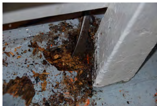
Omfattende rådskade ved en lønningsstøtte
